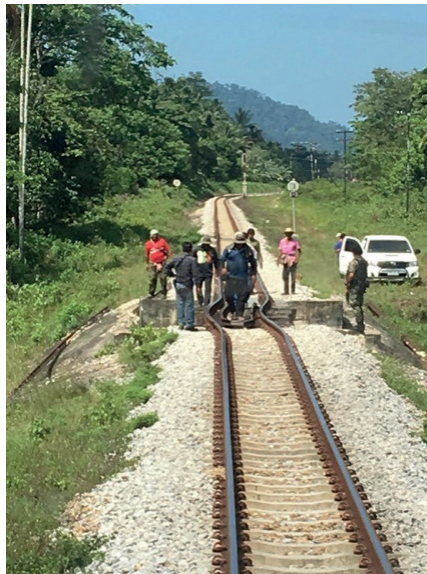
รูปที่ 2 ลักษณะผิดปกติของรางรถไฟเนื่องจากความร้อนของดวงอาทิตย์ [2]
