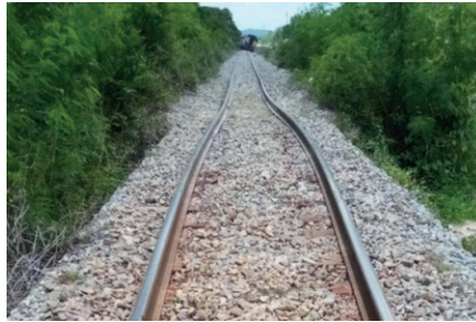
รูปที่ 1 ลักษณะผิดปกติของรางรถไฟเนื่องจากสลักยึดรางหลุดออกจากตำแหน่งติดตั้ง [1]
