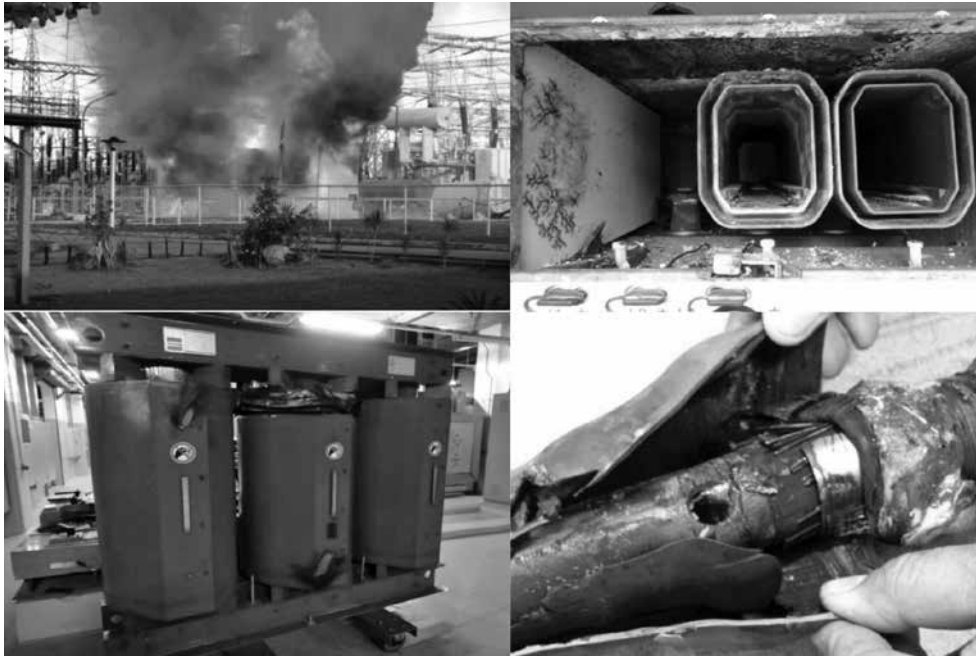
รูปที่ 3 ความล้มเหลวของการฉนวนในอุปกรณ์ไฟฟ้าแรงสูงซึ่งเกิดจากการดิสชาร์จบางส่วน (จากการสำรวจ หน่วยงานของบริษัท แอดวานซ์ เพาเวอร์ อีควิปเมนต์ (ประเทศไทย) จำกัด)
