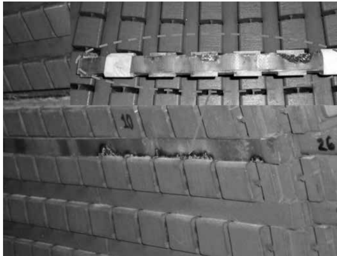
รูปที่ 10 รอยไหม้ภายในสลีตระหว่างขดลวดสเตเตอร์ซึ่งเกิดจากการดิสชาร์จบางส่วน (จากการตรวจสอบหน้างานของ บริษัท แอดวานซ์ เพาเวอร์ อีควิปเมนต์ (ประเทศไทย) จำกัด)
