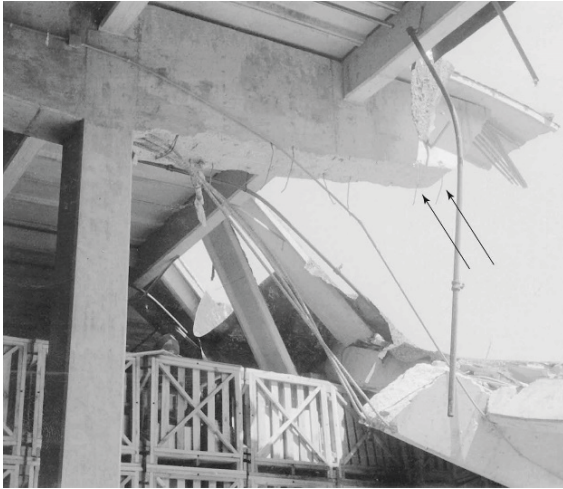
รูปที่ 6 การวิบัติของคานที่ U.S. Warehouse ซึ่งพบว่าเหล็กกล้าตั้งมีปริมาณน้อย และได้ถูกทำให้แตกหัก (fractured) อย่างสิ้นเชิง [34]
